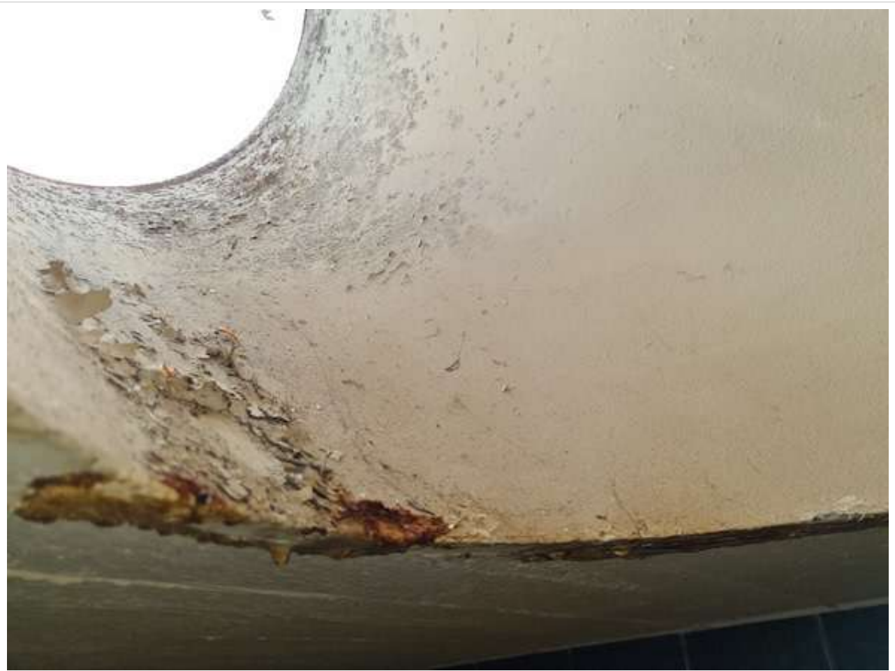
Aperçu de l'érosion du conduit par l'humidité
